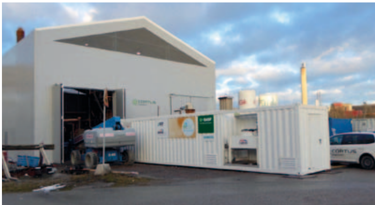
Utanför väderskyddet för testanläggningen står InnoEnergy's container i vilken syngas uppgraderas till förnybar naturgas (SNG). Tester för att verifiera denna nya och kostnadseffektiva teknik kommer att utföras under första delen av 2015. Cortus Energy har för denna teknik tecknat avtal om en kommersialisering.
