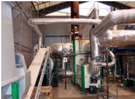
Slutmontage och driftsättning av testanläggningen i Köping om 500 kW syngaseffekt. På bilden syns matningen av biomassa till torken samt hetgasaggregatet.
