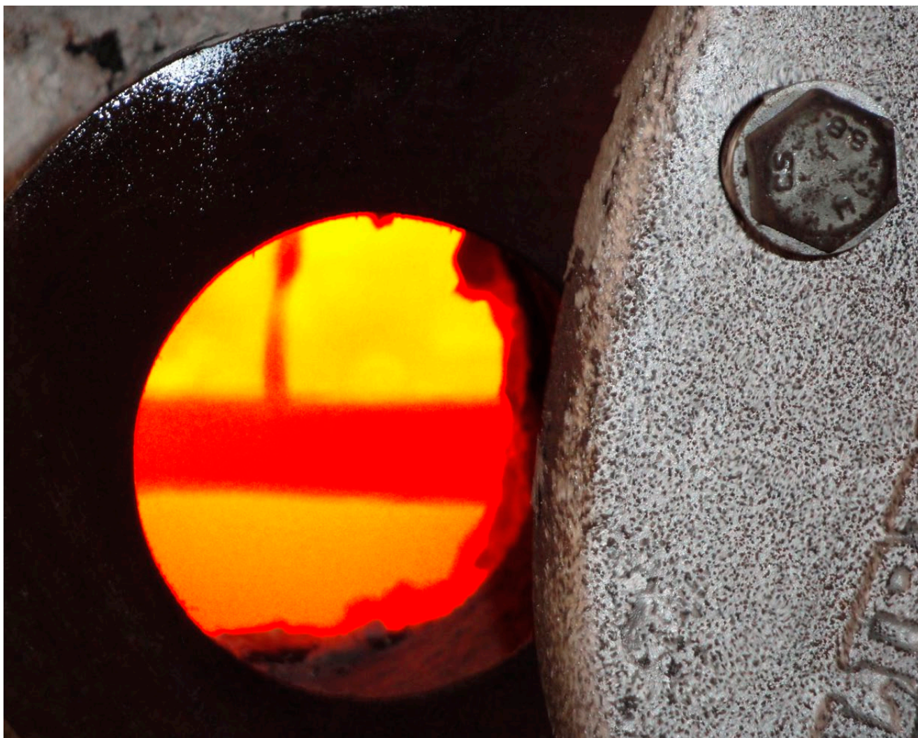
▲ Förbränning av ren energigas i 500 kW-anläggningen i Köping
