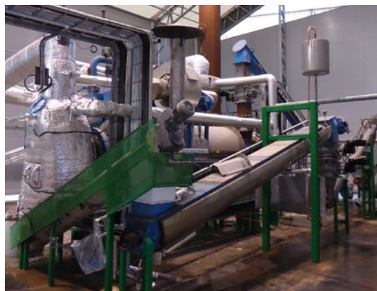
Pyrolysmaskin med kylskruv från anläggningen i Köping
