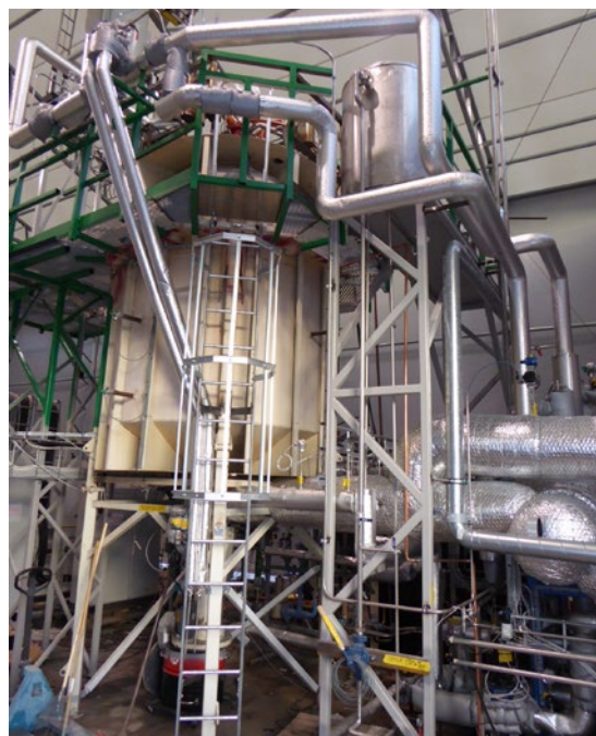
Förgasare om 500 kW med värmeåtervinning och gaskylare/panna i Köping
